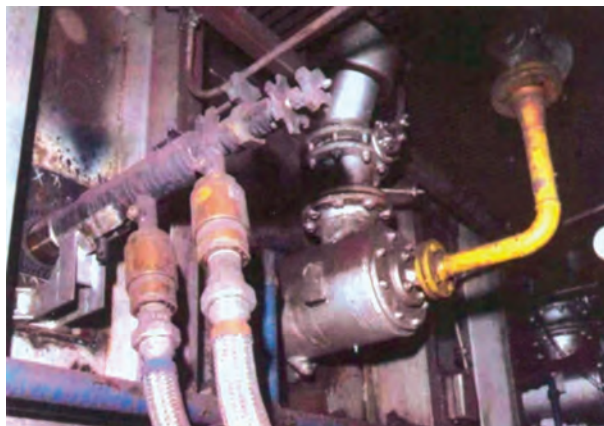
Рис.8. Установка «форсировочной» газокислородной горелки мощностью 1,7 млн ккал/ч рядом с газозвушной мощностью 0,428 ккал/ч.
