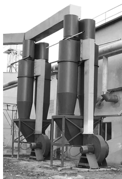
Рис.2. Циклонные фильтры котлов КСВа-2,9Р.
