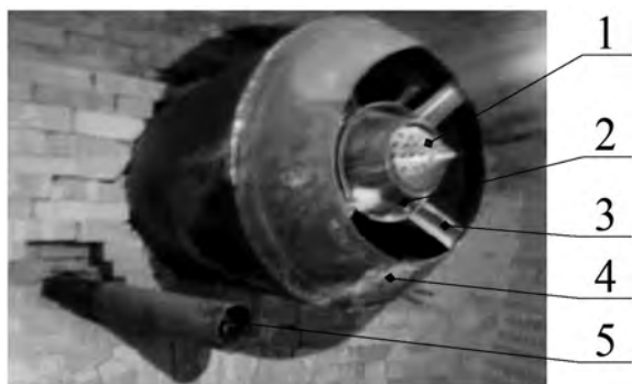
Рис. 4. Установка горелки ПГ-35М в комплекте с ЗЗУ. Вид из рабочего пространства: 1 — конусная часть газораспределительного клапана; 2 — центральное газовое сопло; 3 — стабилизатор; 4 — воздушное сопло; 5 — ЗЗУ.
