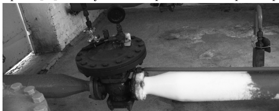
Рис.2. Обмерзание трубопровода после дросселя.
