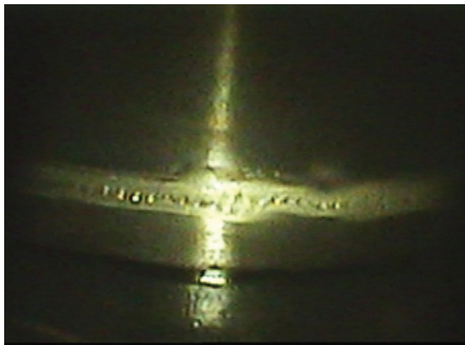
Рис. 3. Дефект механической обработки гидроцилиндра № 2 механизма загрузки мельницы № 3 ПУТ
