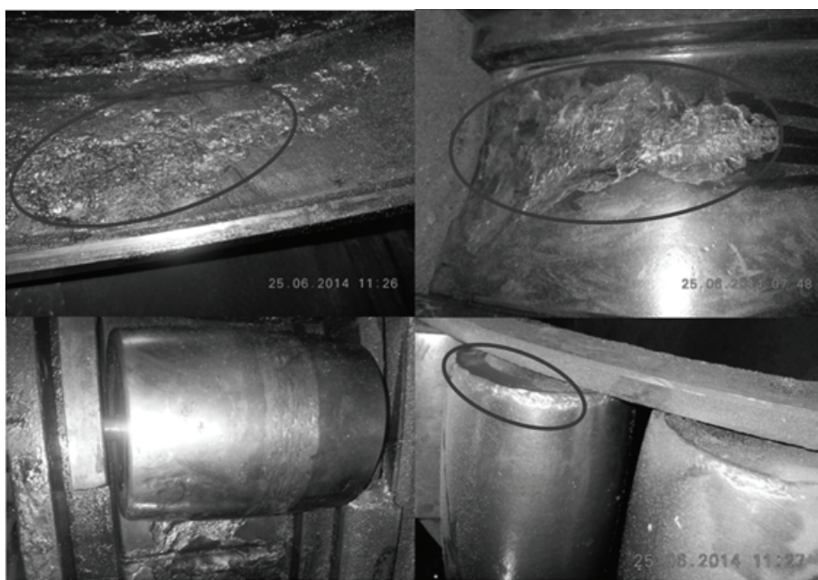
Рис. 5. Раковины на элементах опорного подшипника
