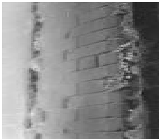
Рис. 4. Дефекты динасовой кладки в камере коксования
