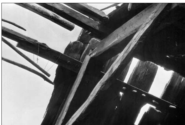
Кріплення дощок покриття до лат кілками (с. Радовель Олевського р-ну Житомирської обл.)
