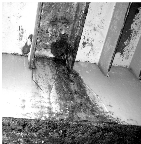
Рис. 1. Корозійні пошкодження головної балки моста через р. Дніпро (Київ).
