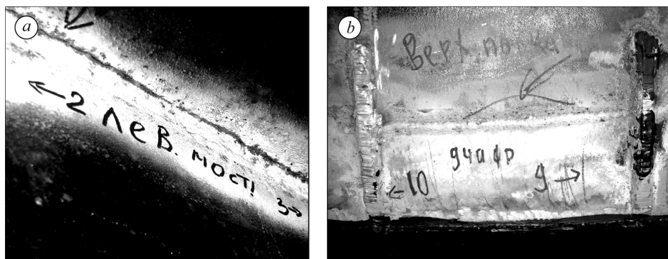
Рис. 1. Тріщини на копструкції перевантажувача: ділянки балок моста (а) та морської консолі (b).
