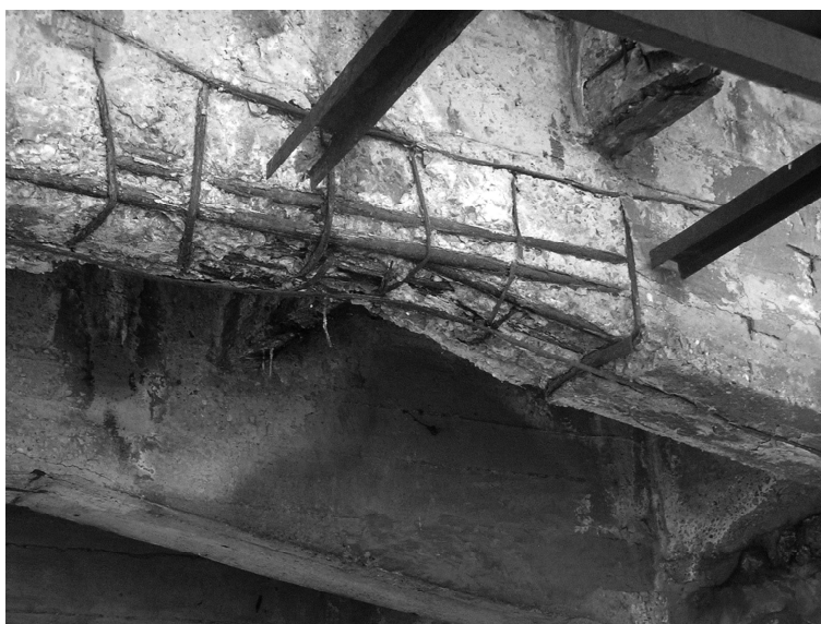
Рис. 1. Результати руйнування захисного шару бетону та корозія арматури Бурсацького мосту у Харкові.
