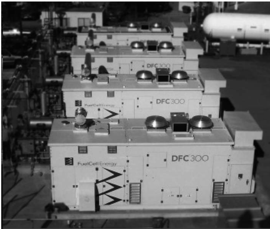
Рис. 3. Вигляд установки з встановленою потужністю 4×300 кВт
