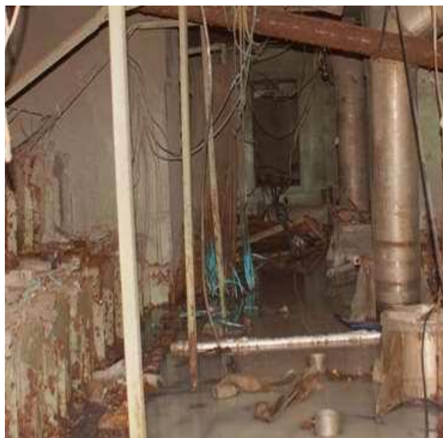
Рис. 2. Южная часть ПРК в рядах Ж – И, залитая водой. Вдали видна дверь, на пороге которой размещали пробирочную трубу с фильтрами Петрянова.
