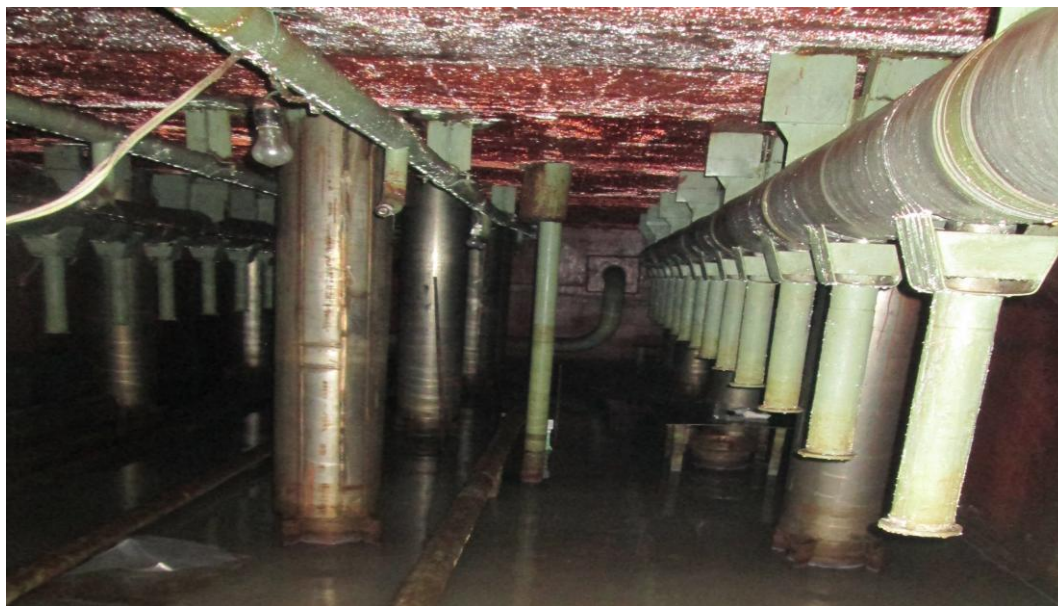
Рис. 8. Конденсат на потолке помещения 012/13(север, отметка +2,20 м).
