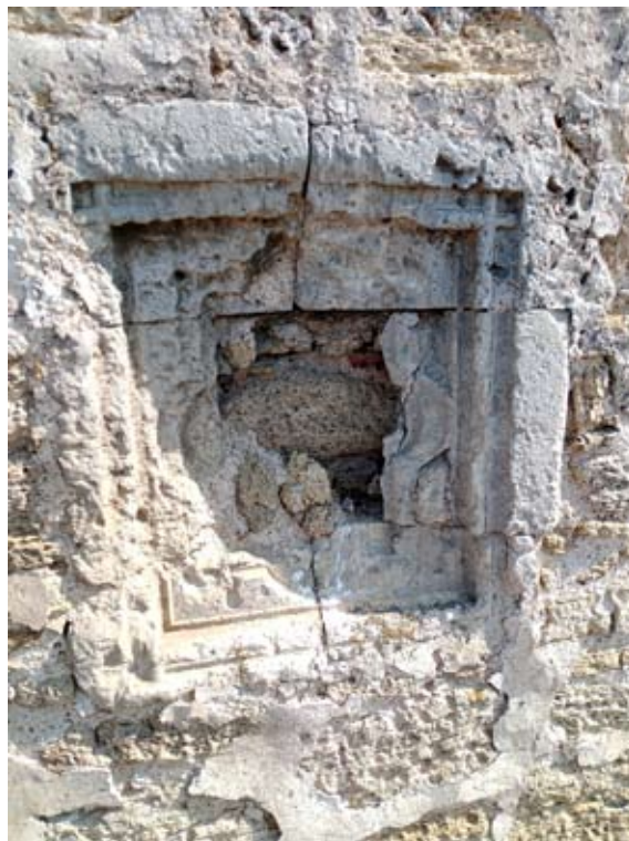
Рис. 10. Пошкоджений квадрифолій на західній куртині цитаделі
