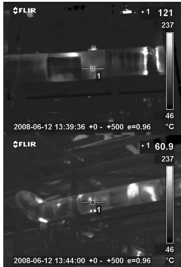
Рис. 2. Типичное в инфракрасном свете распределение температуры в элементах трубопроводов с нарушенной теплоизоляцией
