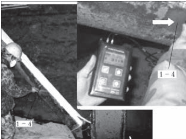
Рис. 5. Местные утонения металла стенок вертикальных связей из замкнутого коробчатого профиля вследствие внутренней коррозии (1-4) (потеря сечения от проектного значения 22 %)
