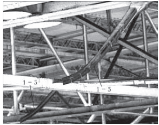
Рис. 6. Механические деформации (погнутости) элементов горизонтальных связей по нижним поясам стропильных ферм покрытия (1-5)
