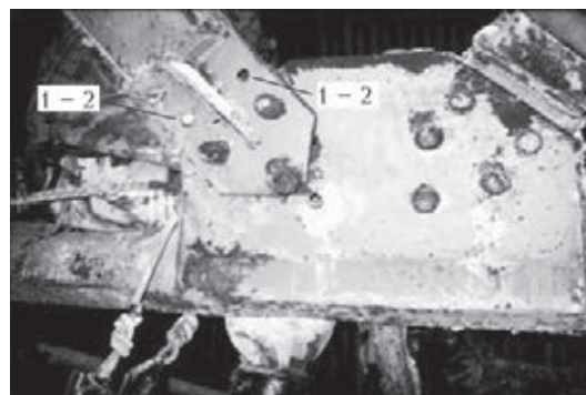
Рис. 3. Дефект монтажа: смещение элементов вертикальных связей в узловой фанонке; отсутствие проектных болтов соединения (1-2) – 3 шт. вместо пяти (предаварийное состояние)
