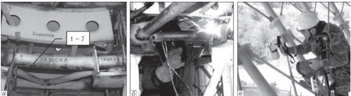
Рис. 11. Ремонтно-восстановительные работы спецоборудования: сквозное коррозионное разрушение стенок полых конструкций (1–7) (а); замена поврежденных элементов (б); нанесение защитного покрытия агрегатами безвоздушного распыления (в)
