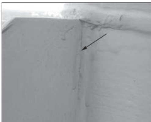
Рис. 4. Характерное повреждение по границе перехода от шва к основному металлу прорезной фасонки
