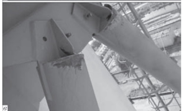
Рис. 6. Трещина в заглушке в зоне ребра левого (а) и правого (б) раскоса длиной около 150 мм по линии (37-Д1)-(37-Ж) ниже отметки +107,72 и общий вид расположения раскосов под площадкой ниже отметки +107,72 в зоне крепления к горизонтальной связи по линии (37-Д1)-(37-Ж) (в)
