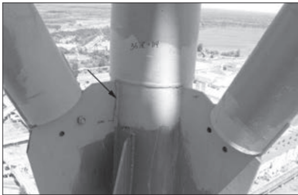
Рис. 2. Узел примыкания раскосов к опорной стойке Ø 325×8 мм в узле 36-Ж на отметке 114,92 м с обнаруженным ранее дефектом (показано стрелкой)
