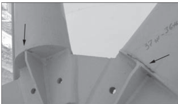
Рис. 5. Характерное повреждение в узле соединения раскосов с распоркой под площадкой (показаны стрелками)
