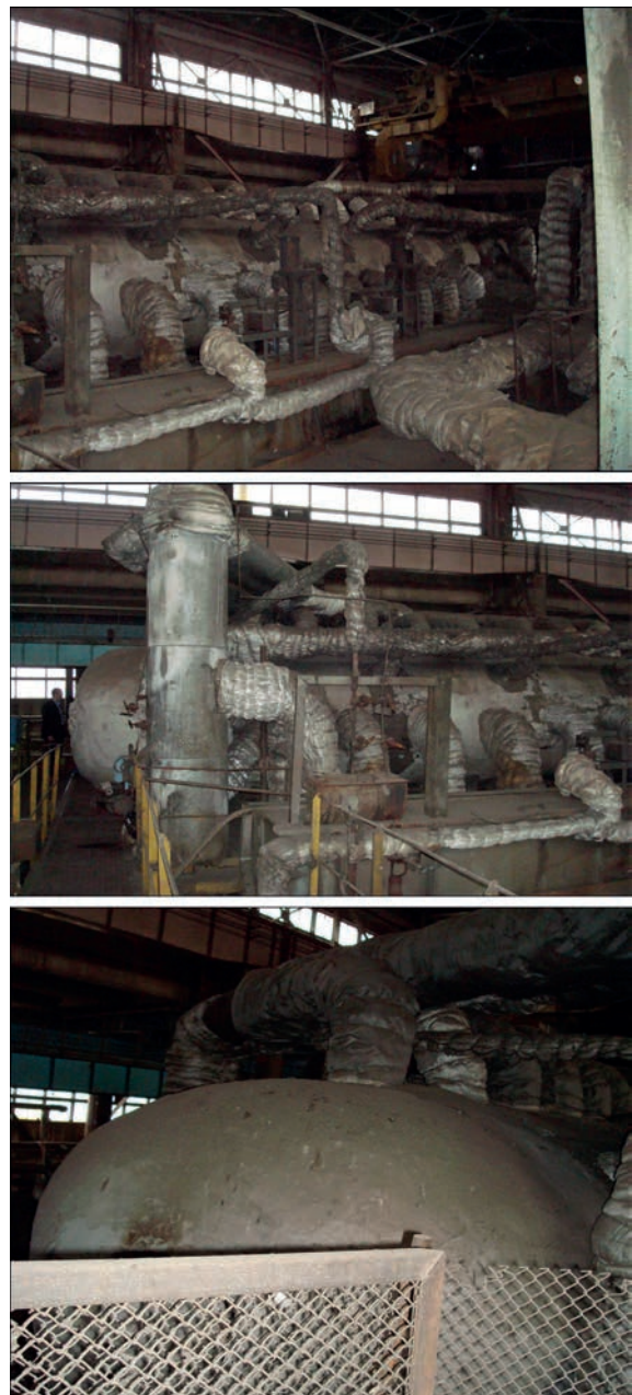
Рис. 1. Внешний вид барабана котла ТГМ-96
