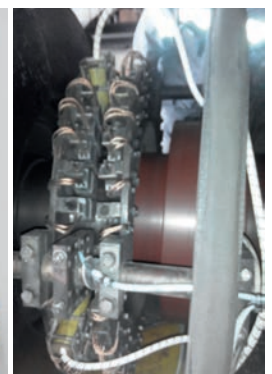
Встановлення датчиків на щітково-контактному апараті турбоагрегата
