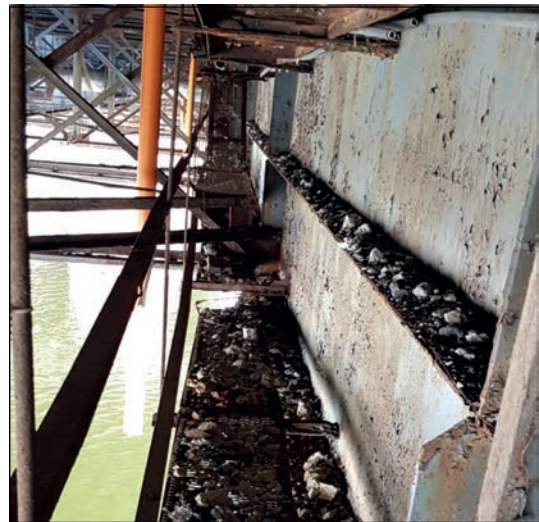
Рис. 6. Приклад скупчення сміття на крайній балці № 4 першої п'ятипрогонної споруди мосту
