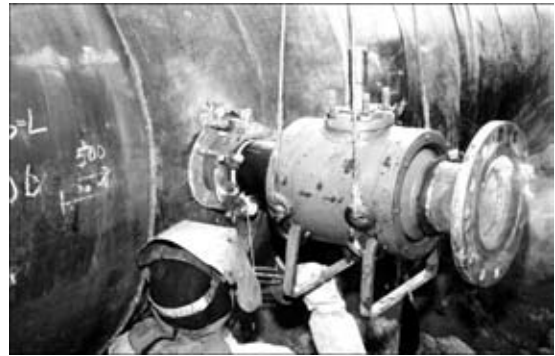
Рис. 9. Присоединение отвода Ду 150 мм к магистральному газопроводу «Союз» Ду 1400 мм, находящемуся под внутренним давлением 4,9 МПа
