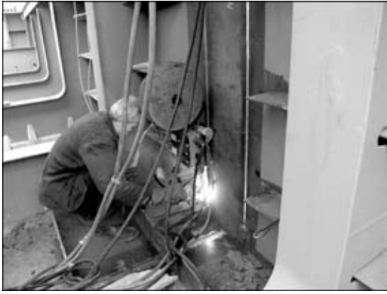
Рис. 5. Сварка порошковой проволокой ПП-АН9Н с принудительным формированием вертикальных стыковых швов пролетных конструкций Подольско-Воскресенского мостового перехода через р. Днепр в г. Киеве
