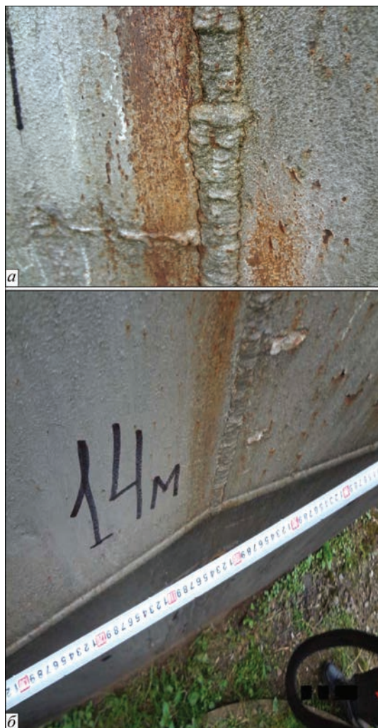
Рис. 3. РВС 10 тыс. м 3 : усталостные трещины по зоне сплавления шва (а); угловые деформации в вертикальном стыковом монтажном сварном соединении стенки (б)
