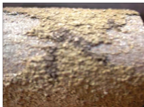
Рис. 12. Внешний вид трубы после 6 лет эксплуатации (испытание на схождение сторон)
