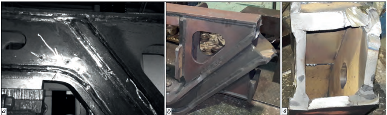
Рис. 6. Фрагмент руйнування дослідного зразка № 2 суцільнозварної бічної рами після утворення макротріщини під час прискорених випробувань на втому (а) та після руйнування в зоні радіусного переходу R55 буксового отвору (б, в)
