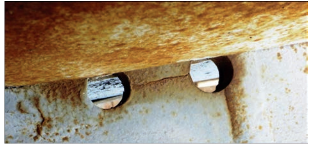
Рис. 7. Приклад відсутності росту дефекту, залишеного під час монтажу (кінці тріщини були зупинені методом свердлування) [4]
