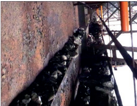
Рис. 8. Ділянка скупчення сміття та стану оглядових проходів з внутрішньої сторони крайньої балки п'ятипрогонової споруди
