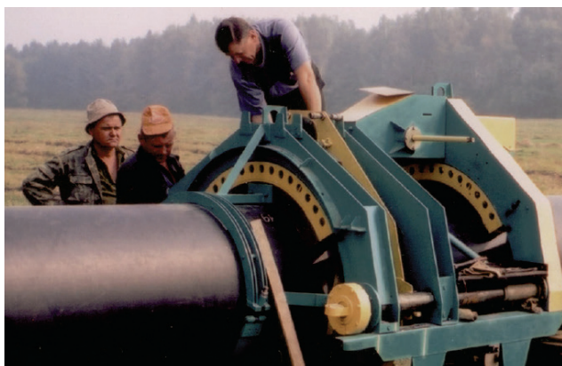
Зварювання нагрітим інструментом встик поліетиленових труб зовнішнім діаметром 800 мм із застосуванням модернізованої установки конструкції ІЕЗ при реконструкції сталевого дюкера діаметром 900 мм, проложеного по дну Південного Бугу біля м. Вінниці
