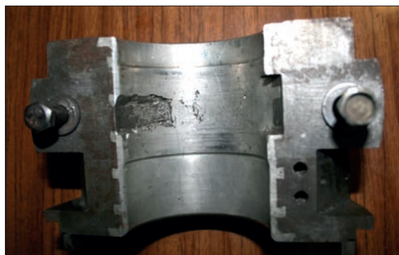
Рис. 3. Вкладыш підшипника живильного насосу ТЕЦ до ремонту
