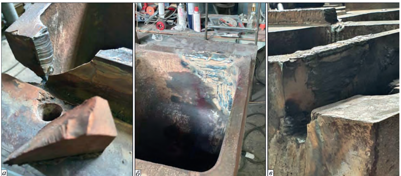
Рис. 4. Загальний вигляд ділянки ремонту тріщини № 1 на передній стінці (а), після термічного видалення фрагмента стінки (б), після зварювання (в) відповідно з середини та зовні
