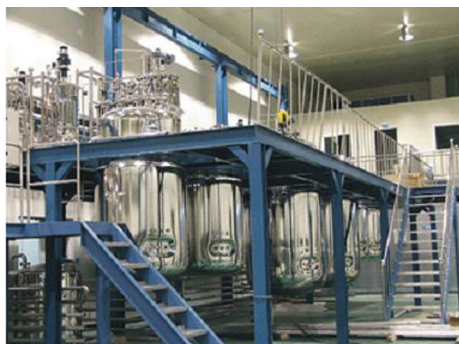
Рис. 3. Ферментери фірми Biotron, що встановлені на підприємстві Kyongbuk Bio industrial research worker (Південна Корея)
