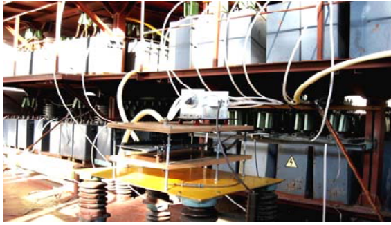
Рис. 7. Общий вид мощного высоковольтного сильноточного генератора тока искусственной молнии типа ГТМ-10/350 (на переднем плане находится его рабочий стол с размещенным сверху на нем управляемым высоковольтным трех-электродным воздушным коммутатором с графитовыми электродами на напряжение \pm 50 кВ и импульсный аperiodический ток молнии амплитудой до \pm 220 кА и испытываемым образцом кабельно-проводниковой продукции, а на заднем плане – электротехнические элементы зарядно-разрядных цепей его отдельных высоковольтных генераторов импульсных токов ГИТ-1, ГИТ-2, ГИТ-3 и ГИТ-4) [21]
