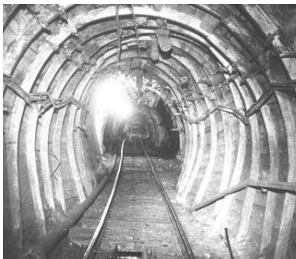
Рис. 17. Характер деформирования сечения вентиляционного ходка, расположенного в обрушенных и уплотненных породах
