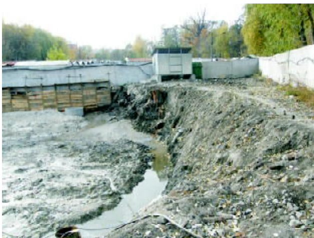
Рис. 1. Истоки грунтовой воды на территории строительной площадки
