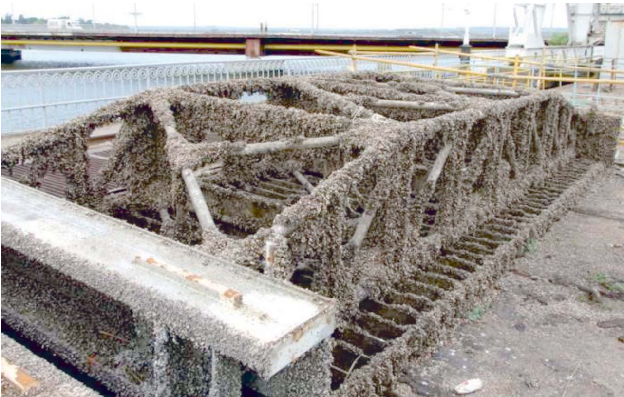
Фото 1. Сороудерживающая решетка Г-7 ДГЭС-1 после четырех лет работы
