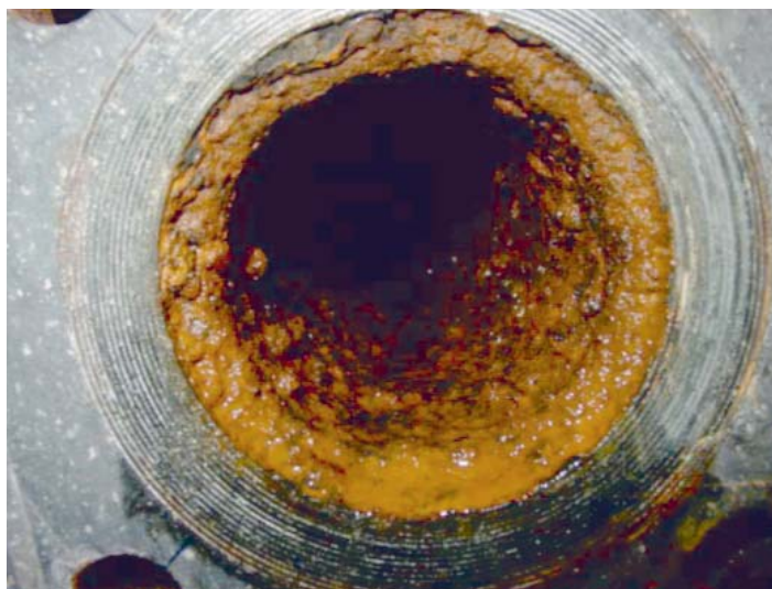
Фото 3. Нарастание моллюсков внутри трубопровода "сырой" воды
