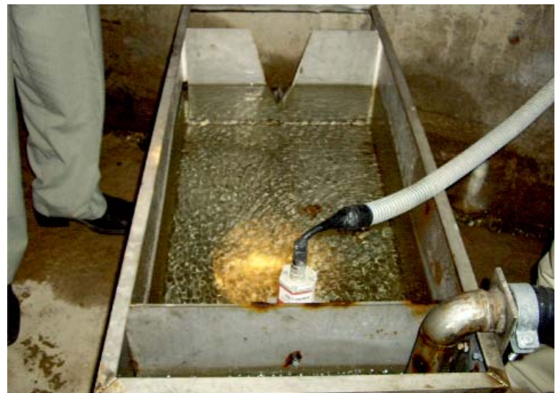
Рис. 9. Акумуляція фільтраційної води, вимірювання її витрати та відбір проб для аналізу процесів корозії бетону
