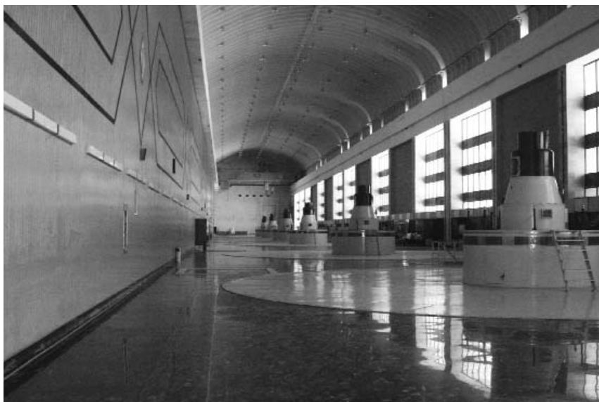
Рис. 5. Машинний зал ГЕС Тишрінського гідровузла
