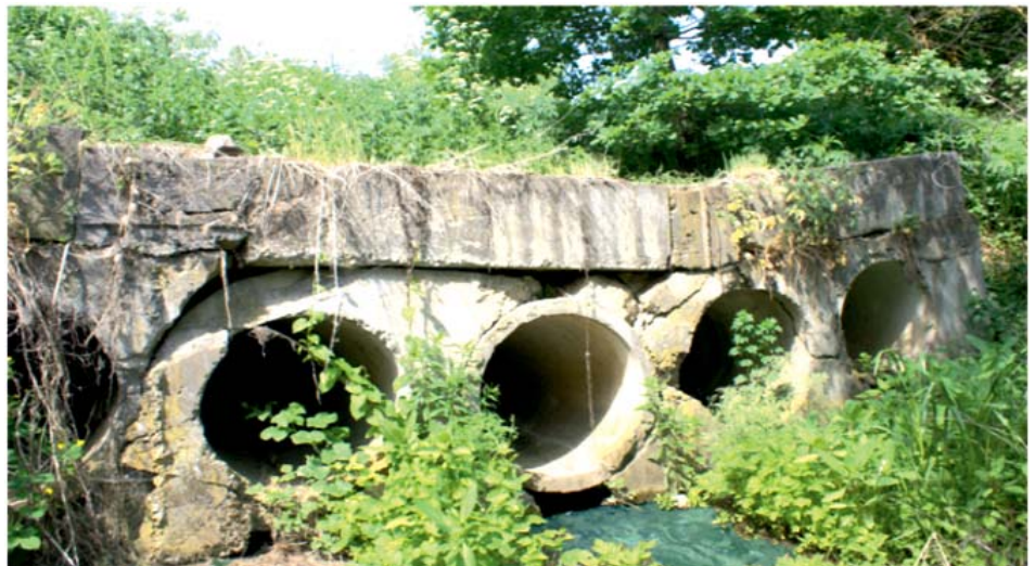
Рис. 3. Катастрофическая деформация сооружения аварийного водосброса плотины на р. Згар
