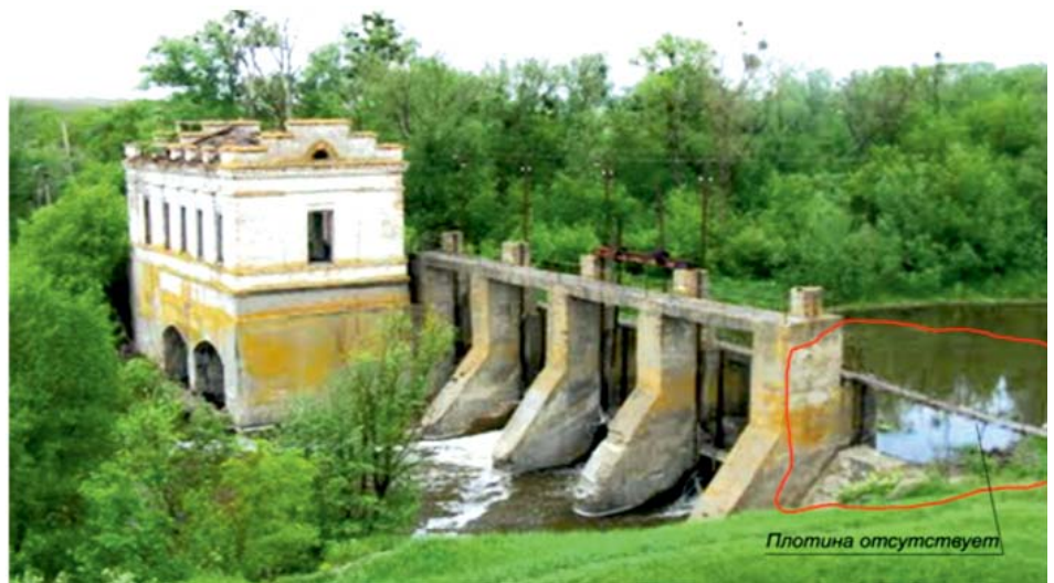
Рис. 2. Аварийное разрушение плотины МГЭС на р. Горный Тикич
