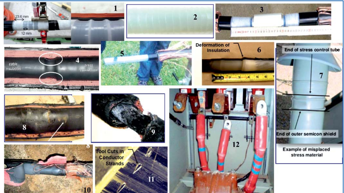
Рис. 22. Недостатки и повреждения муфт при монтаже: 1 – воздушные полости внутри муфты [33]; 2 – отшлифованная с полосами поверхностью элементов [33]; 3 – укороченный полупроводящий слой по изоляции справа от соединителя [33]; 4 – впадины в изоляции кабеля [41]; 5 – дефект при разделке под муфту [40]; 6 – деформированная изоляция [10]; 7 – неправильное расположение регулирующего материала [38]; 8 – загрязнение поверхности [10]; 9 – повреждение шейки муфты из-за залама [40]; 10 – затягивание проволоки экрана под трубку [40]; 11 – разрезы на проводниках жили [10]; 12 – залом наконечника при присоединении фаз кабеля [40].
