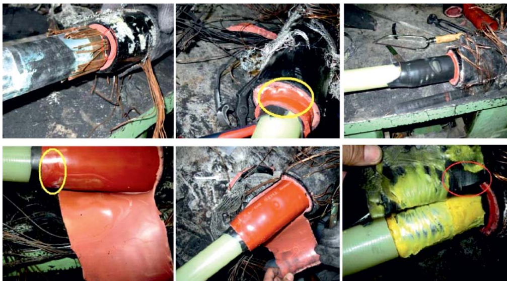
Рис. 26. Следы частичных разрядов в муфтах фирмы Raychem из-за некачественно выполненного монтажа [71].
