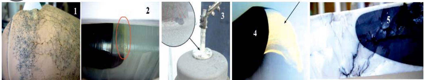
Рис. 23. Повреждения муфт кабелей на высокое и сверхвысокое напряжение: 1 – скользящие разряды на поверхности конуса при попадании влаги в концевую муфту на напряжение 220 кВ [59]; 2 - следы перегрева соединительной муфты 110 кВ при ресурсных испытаниях [59]; 3 - трещина в месте изгиба токовывода концевой муфты [57]; 4 - отслоение изоляции от регулирующего электрода в соединительной муфте на напряжение 220 кВ [58]; 5 - электрический пробой изоляции концевой муфты из-за некачественной обработки поверхности изоляции кабеля [57].
