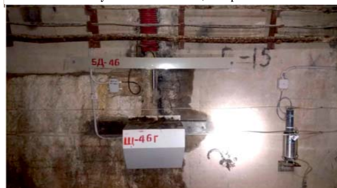
Рис. 5. Комутаційно-вимірювальний пункт (група локальних онцентраторів) в технічному приміщенні
