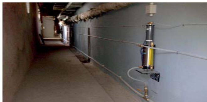
Рис. 4. Елементи дистанційної гідронівелірної системи, установлені на стінці галереї
