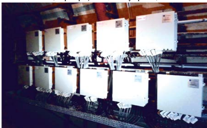
Рис. 3. Комутаційний пункт в потерні водозливної греблі
