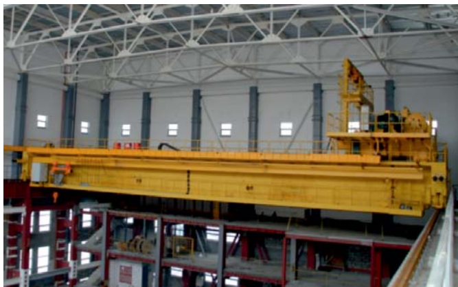
Рис. 3. Кран мостовой г.п. 180+2×70 т, Запорозжская АЭС, Украина
