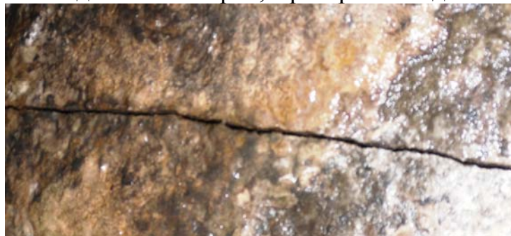
Рисунок 2 – Внешний вид первичной трещины в кровле камеры гипсовой шахты
