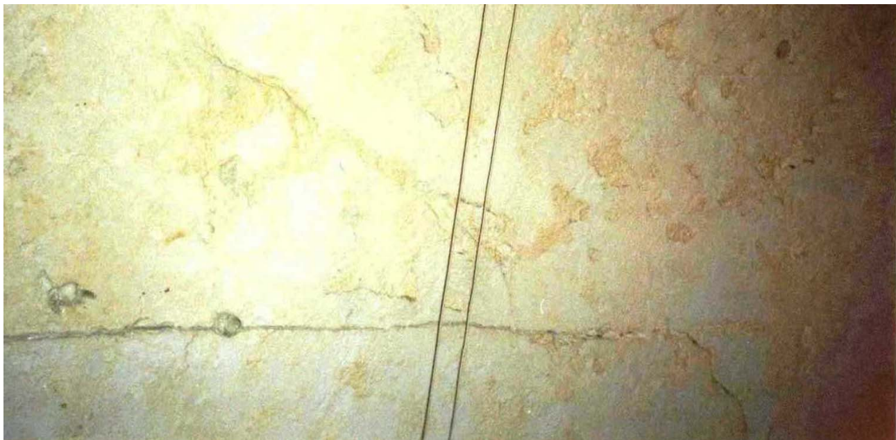
Рисунок 3 – Вторичная трещина в потолочине 35 камеры Артемовской гипсовой шахты
