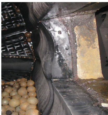
а – хвилювий знос футеровочних плит млина під час проміжного огляду;
