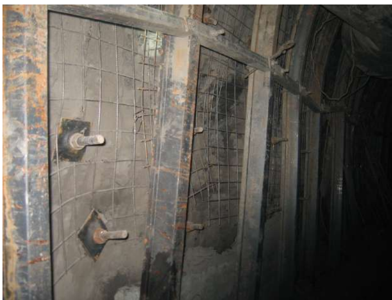
Рисунок 20 – Состояние 2-го западного откаточного штрека
