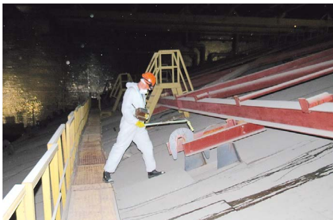
Рис. 1. Значне запилення горизонтальних поверхонь металоконструкцій на покрівлі об'єкта «Укриття», листопад 2021 р.
