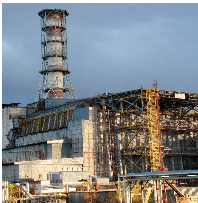
Рис. 5. Загальний вигляд засобів шляхів доступу (сходові клітки і підйомник по осі С, 55) у район північних щитів-«ключок» із західного боку об'єкта «Укриття»
