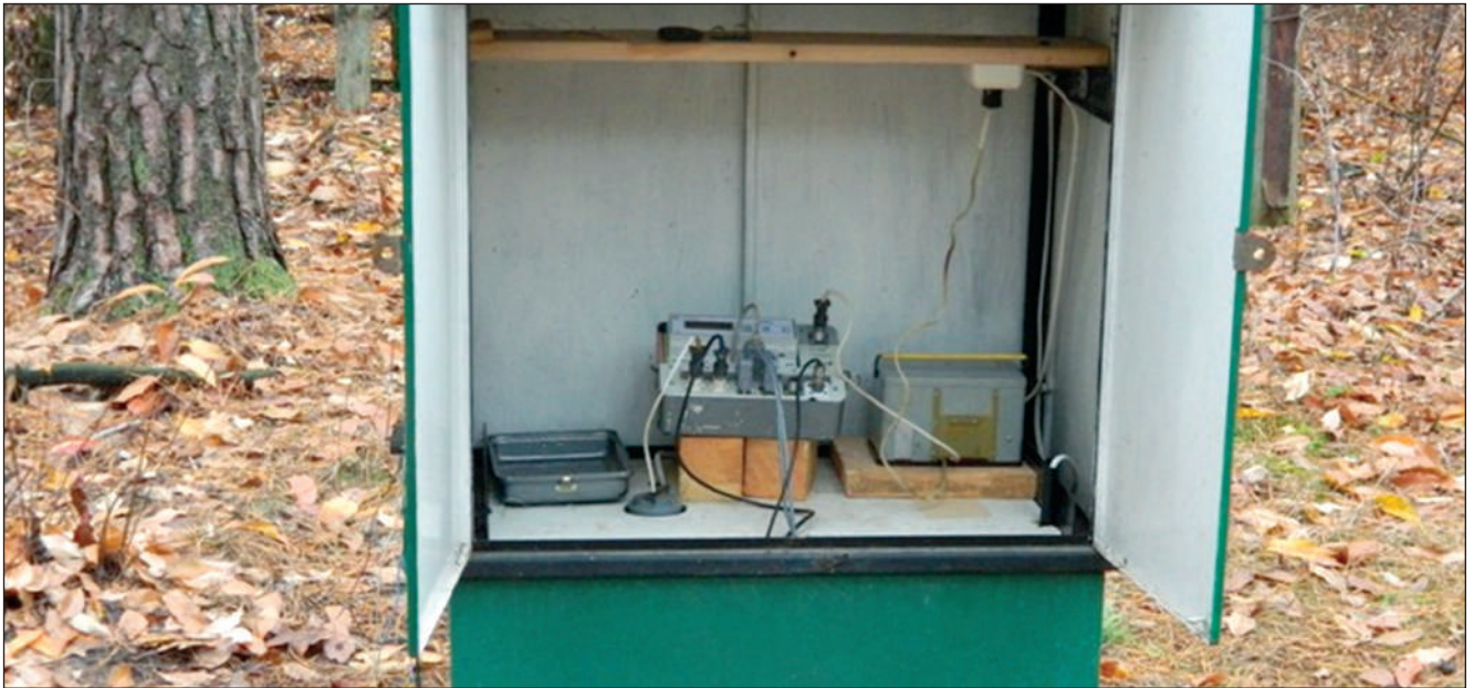
Рис. 1. Гідрогеофізична 8-канальна станція синхронного вимірювання і автоматичного записування показників зони аерації
