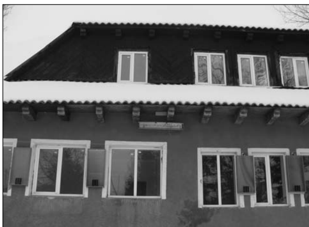
Рис. 5. Встановлення сонячних теплових повітряних колекторів на будинку Катехитичної школи (сmt Делятин, Надвірнянський р-н, Івано-Франківська обл.)
