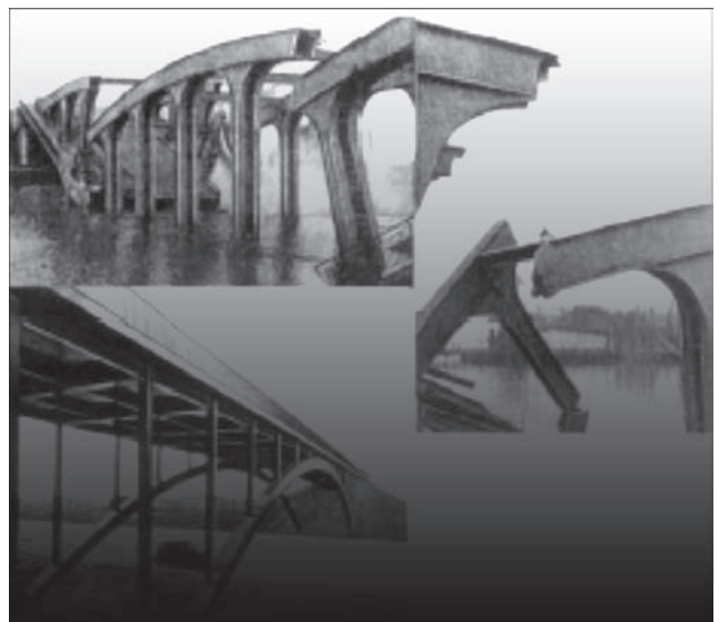
Рис. 2. Руйнування зварного моста через канал Альберта (1938)
