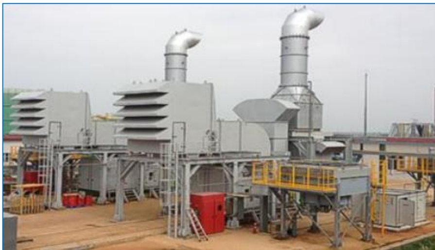
Рисунок 2. Газотурбіна електростанція ДП НВКГ «Зоря»-«Машпроект». Електрична потужність 6 МВт. Установлена в Південно-Східній Азії [6]
