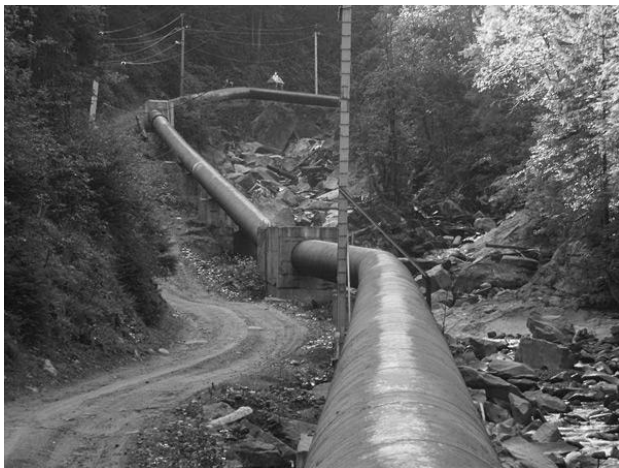
Рис. 7. Дериваційний водовід малої ГЕС на р. Пробійна.
